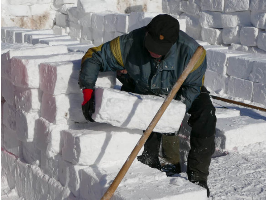
Mit großen Kräfteinsatz und der Hilfe von Kettensägen entstanden die Quader aus verdichtetem Schnee, mit den die Wände aufgebaut wurden. Foto: Sebastian Barthmes
